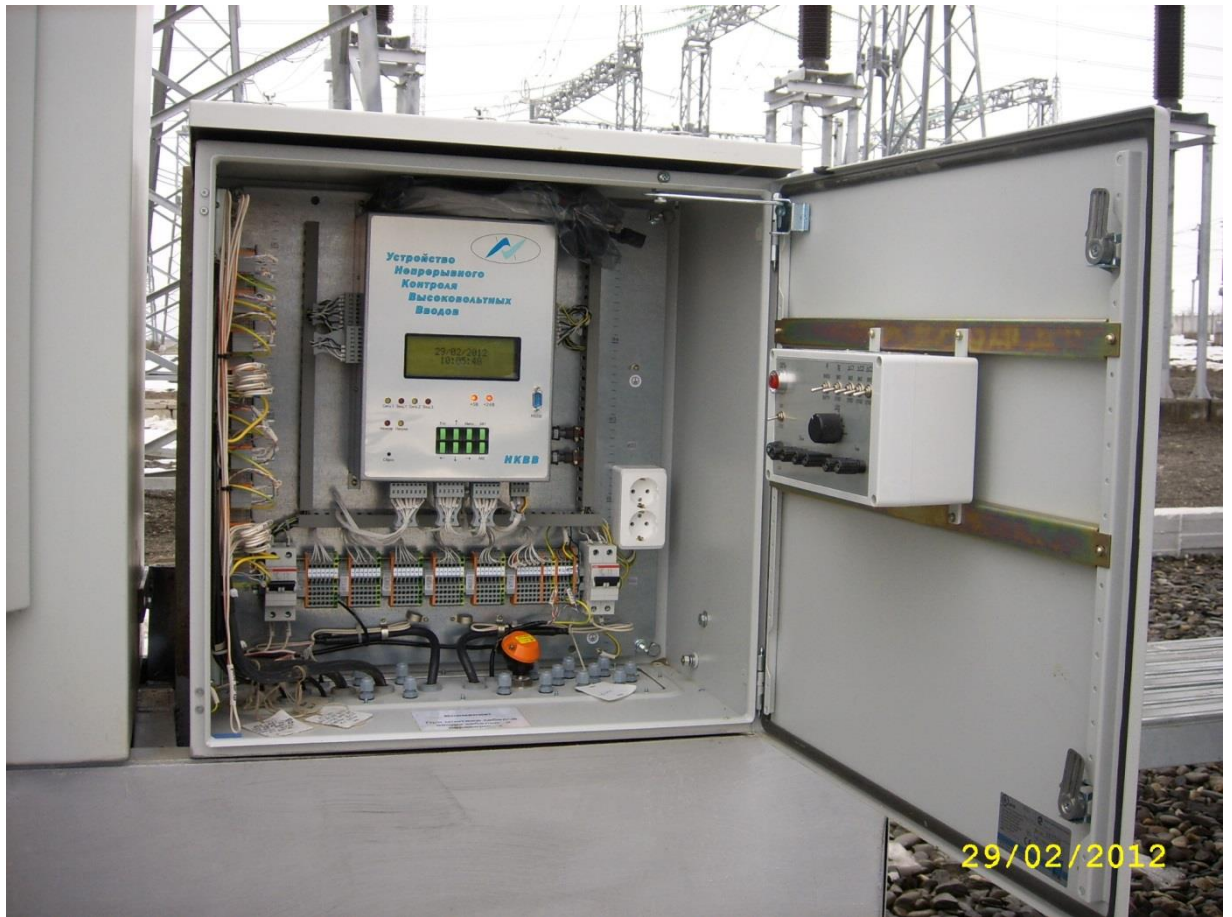
Рис.4 Устройство НКВВ на ПС «Грозный»
